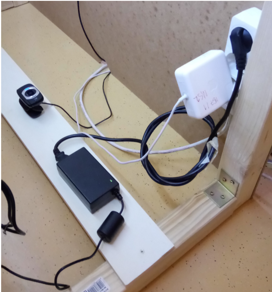
Abbildung 9: Webcam, Stromversorgung der LEDs, Verteilersteckdose
